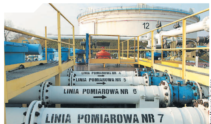
↑ Контрольно-измерительные линии на пункте сдачи нефти «Адамова Застава» в Польше.
